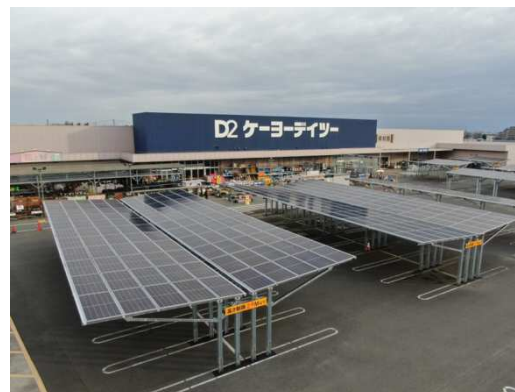
再生可能エネルギー活用
